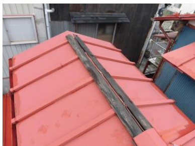
風災での屋根の破損
