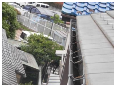
雪災での雨樋の破損
