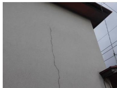
地震によるひび割れ
